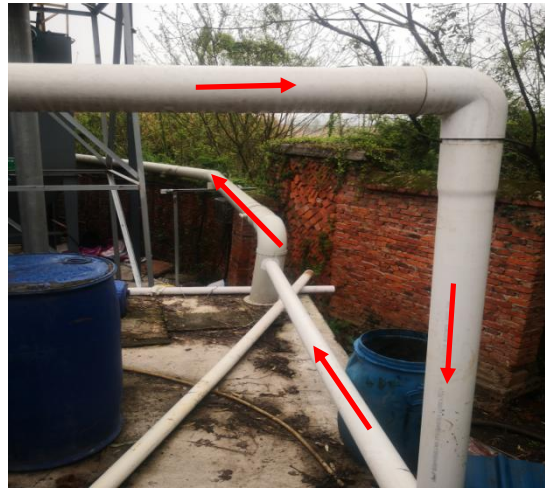
污水处理站废气收集管道
