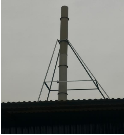
DA002监测孔及采样平台
