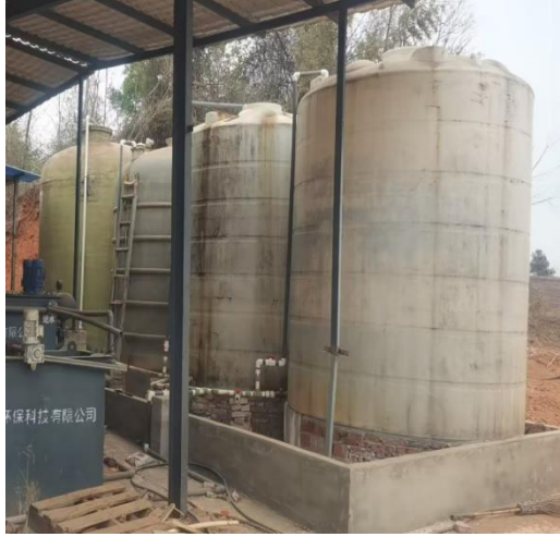
处理后的废水吨桶储存设施
