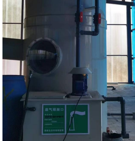
DA002废气标识牌
