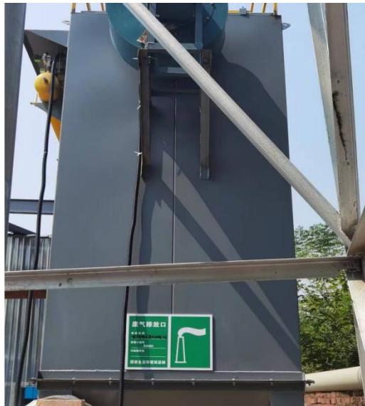
DA001废气标识牌
