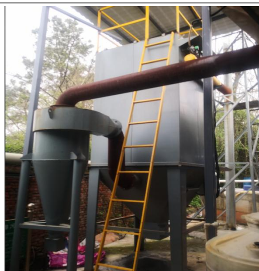
旋风除尘+布袋除尘器（锅炉废气）
